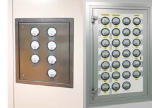
Pannelli di controllo in HPL o acciaio inox per il monitoraggio delle pressioni ambientali (differenziali)
