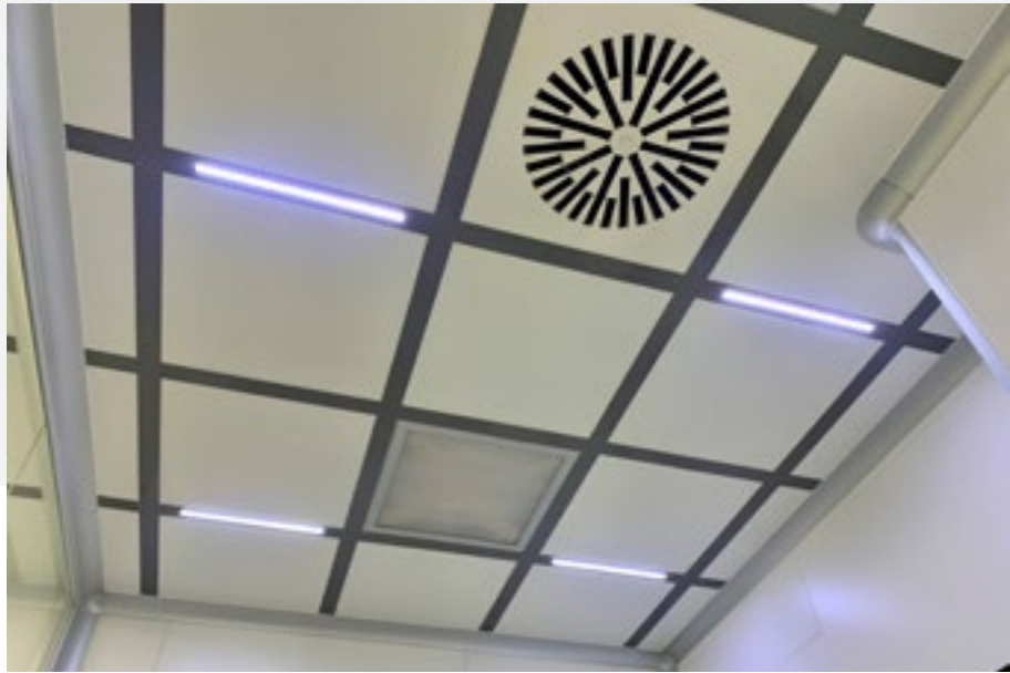
Luci LED incorporate nei profili del controsoffitto
